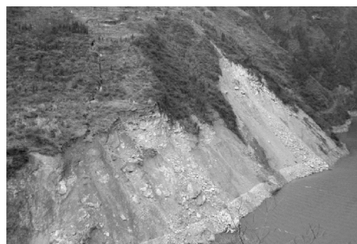
图 4 青石岸坡前缘垮塌
